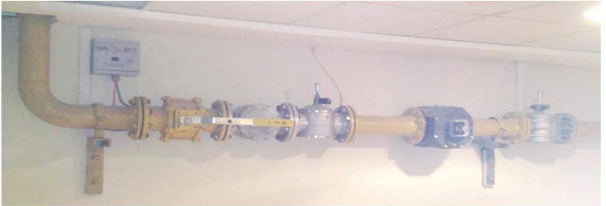
KRISTALŞEHİR-BEYLİKDÜZÜ 1.KISIM 1.BLOK DOĞALGAZ SAYAÇ GRUBU
