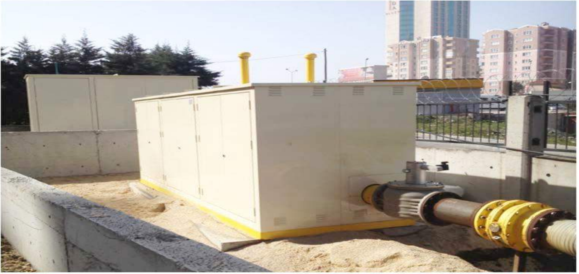
KRİSTALŞEHİR 2.ETAP RS-C 5.000 m 3 /h 2.KADEME DOĞALGAZ BASINÇ DÜŞÜRME İSTASYONU
