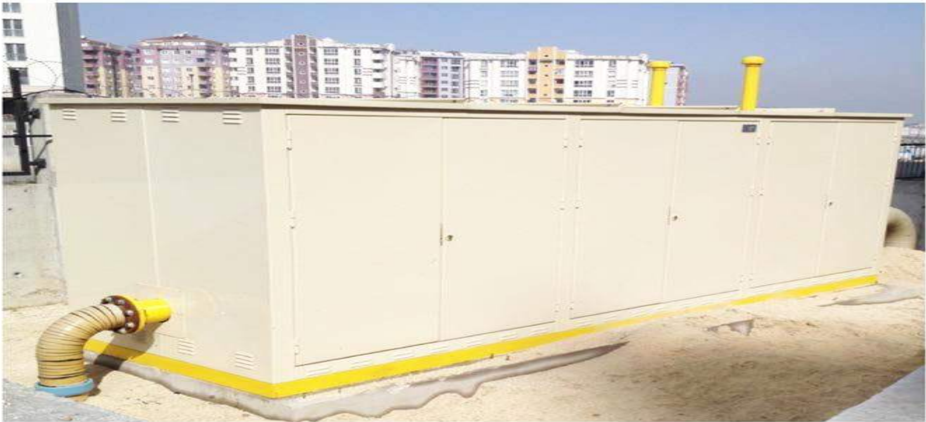
KRİSTALŞEHİR 2.ETAP RS-C 5.000 m 3 /h 2.KADEME DOĞALGAZ BASINÇ DÜŞÜRME İSTASYONU
