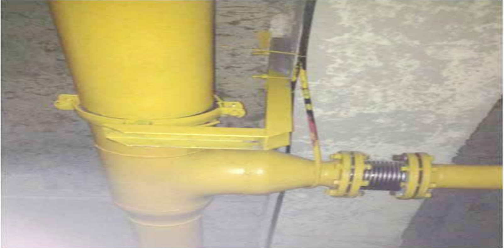
KRİSTALŞEHİR- BEYLİKDÜZÜ 1.KISIM DOĞALGAZ KOLON TESİSAT
