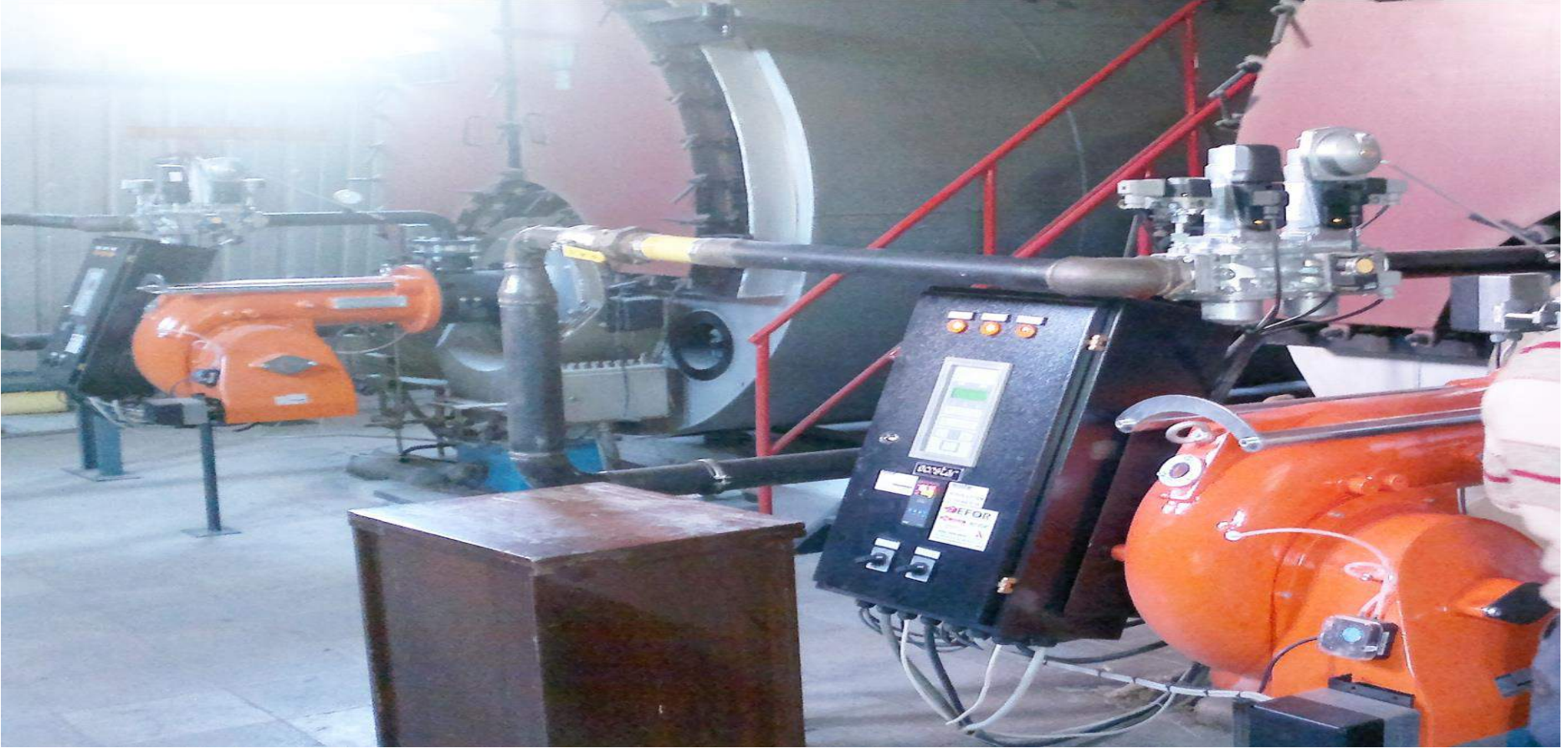
HALKALI TOPLU KONUTLAR ISI MERKEZİ MİKRO PROSESÖR KONTROLLÜ BRÜLÖR VE DOĞALGAZ
