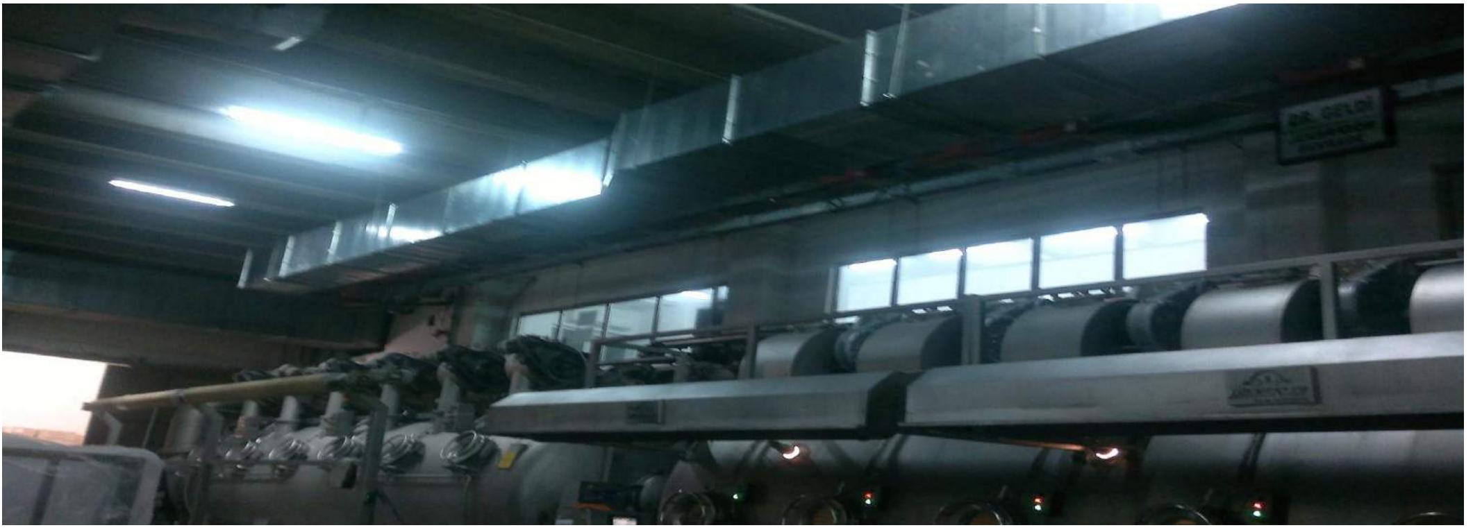
AYDIN MENSUCAT KASAR BÖLÜMÜ HAVALANDIRMA TESİSATI
