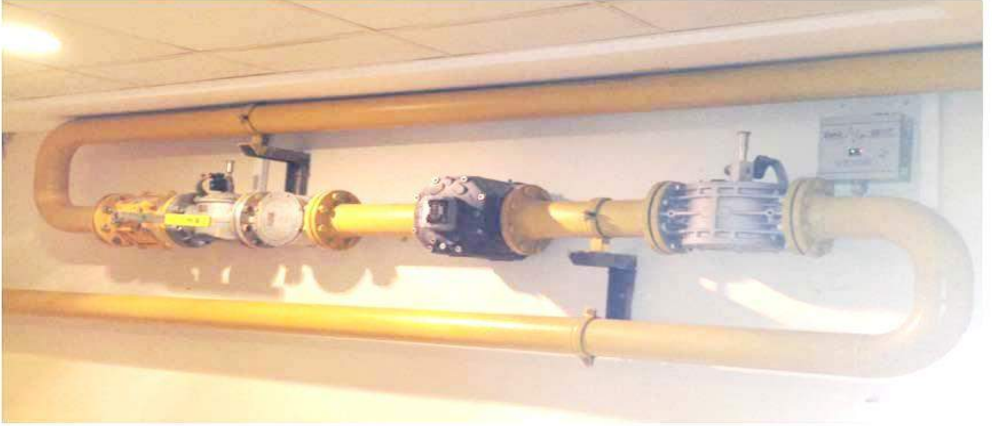
KRISTALŞEHİR-BEYLİKDÜZÜ 1.KISIM 2.BLOK DOĞALGAZ SAYAÇ GRUBU
