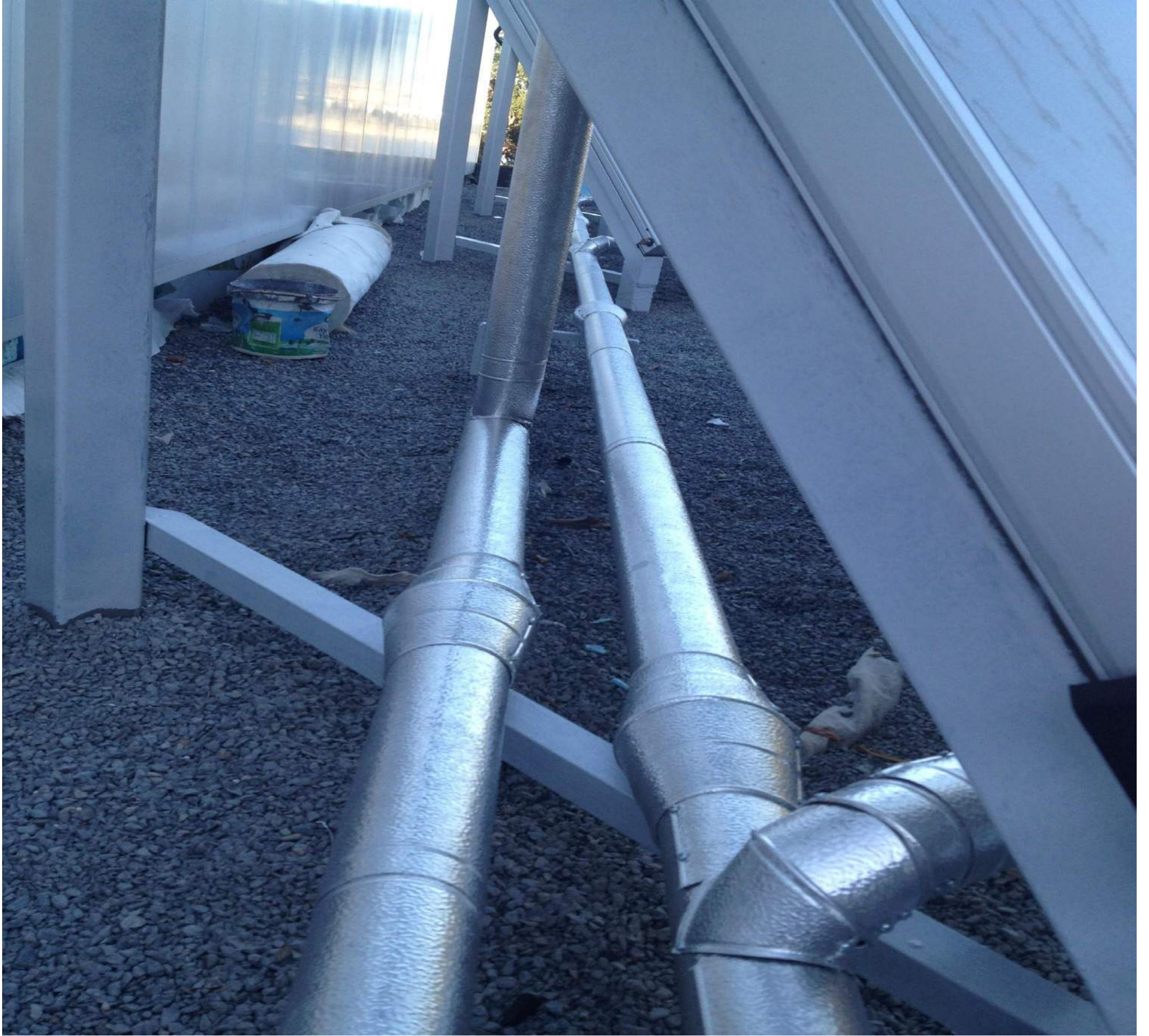
GS KALAMIŞ YÜZME KULÜBÜ GÜNEŞ ENERJİSİ
