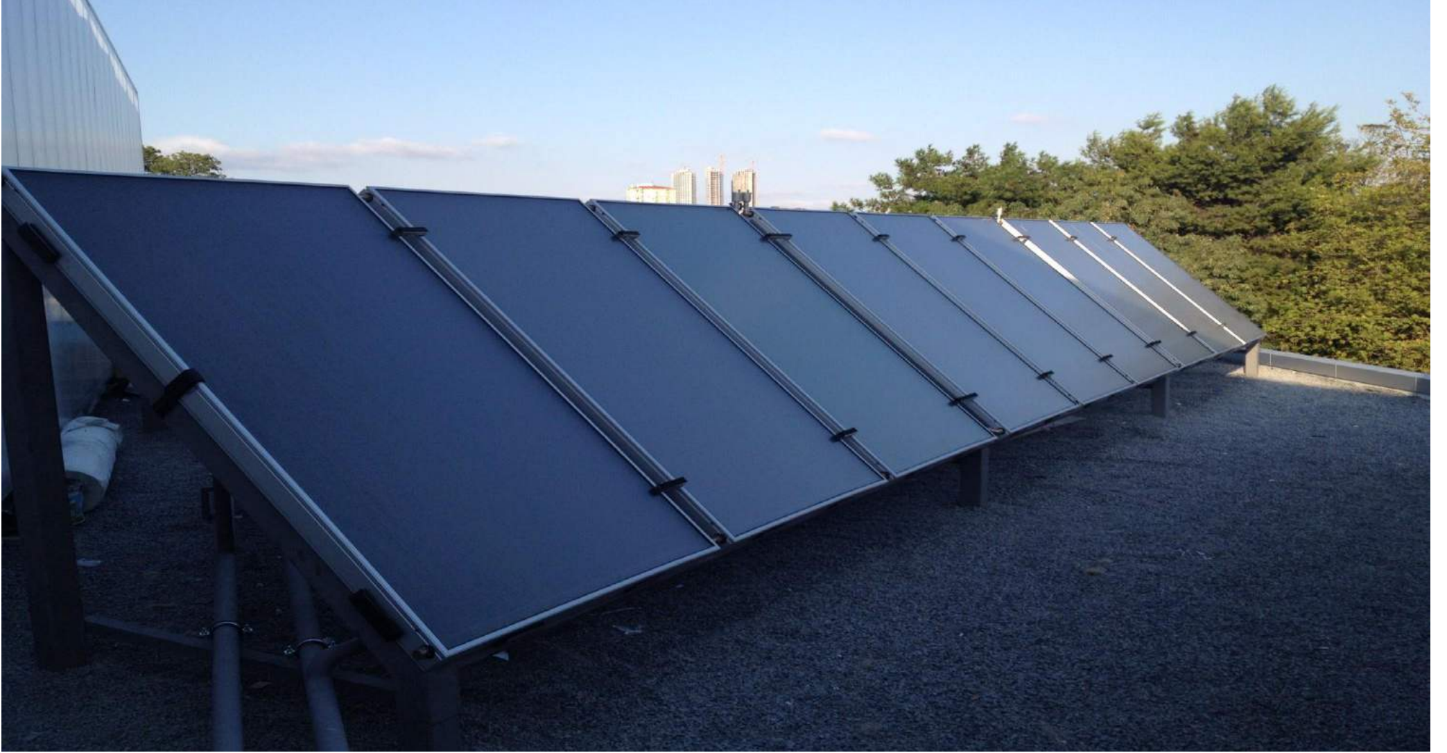
GS KALAMIŞ YÜZME KULÜBÜ GÜNEŞ ENERJİSİ
